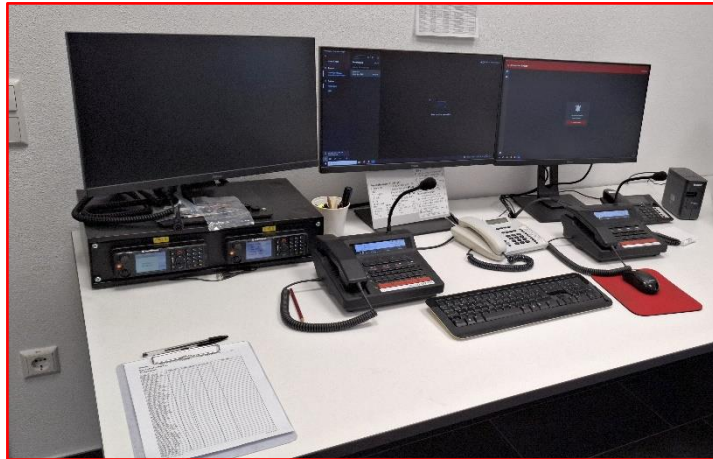
Der auf Digitalfunk umgerüstete Funkraum
